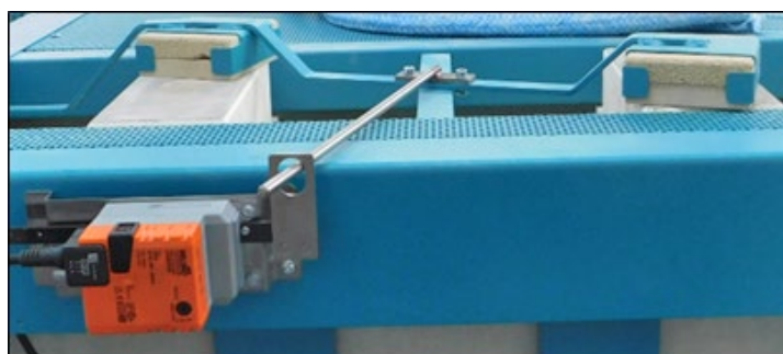
Figure 25 : Trappe automatique d'évacuation d'air
